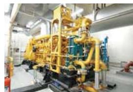
新しい自家発電機
